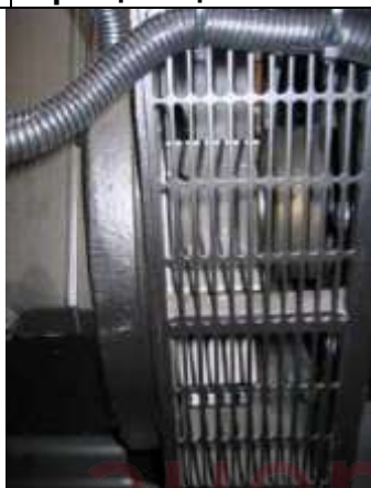
Рис.3 Зона генераторного вентилятора и стыковочных частей
