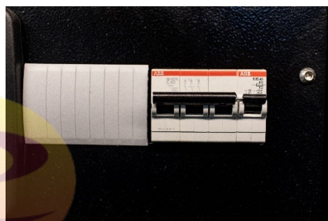
Электрическая часть ДГУ производства АВВ
